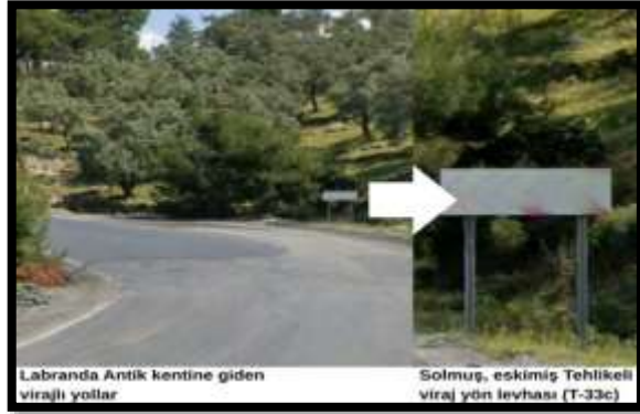
Şekil 3: Labranda Antik Kenti güzergâhındaki fiziki koşullar: (a) Tirmanış etabındaki keskin viraj geometrisi, (b) İşlevini yitirmiş ve okunabilirliği azalmış trafik uyarı levhaları.
