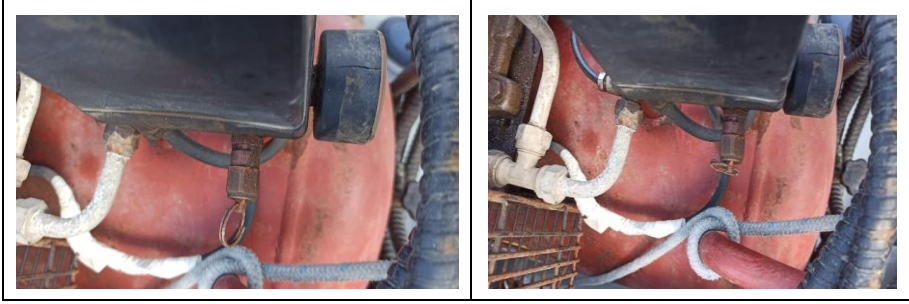
Şekil 6: Korozyona uğramış emniyet valfleri
